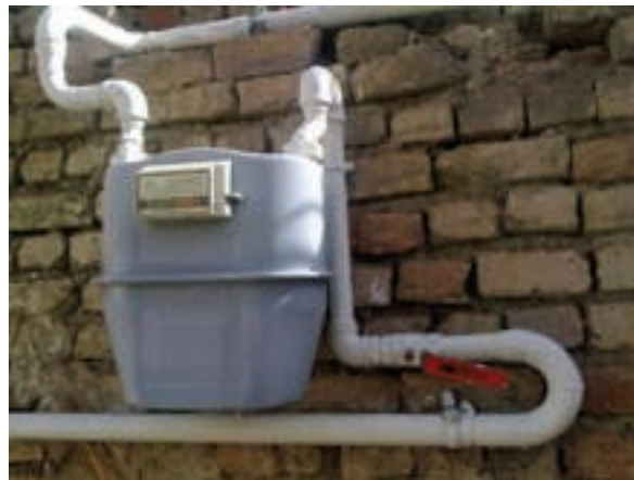
شکل ۸۱-۴ یک کنتور ۱۰ متری نصب شده
